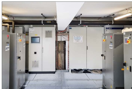
Schaltschrank mit S7 Steuerung
