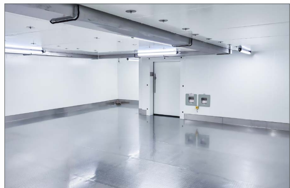
Lagerraum mit 185 m 3 , flexibel Temperierbar von - 20 °C bis + 90 °C
